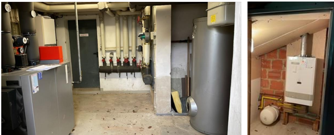
Abbildung 23: Heizungsraum Mehrzweckhalle (links) und Heizung Feuerwehr (rechts)
