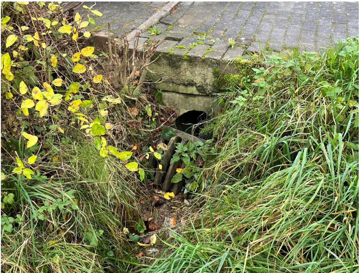
Abbildung 5: Kuhweg Verrohrung unter Einfahrt mit Abdeckung Regeneinlauf
