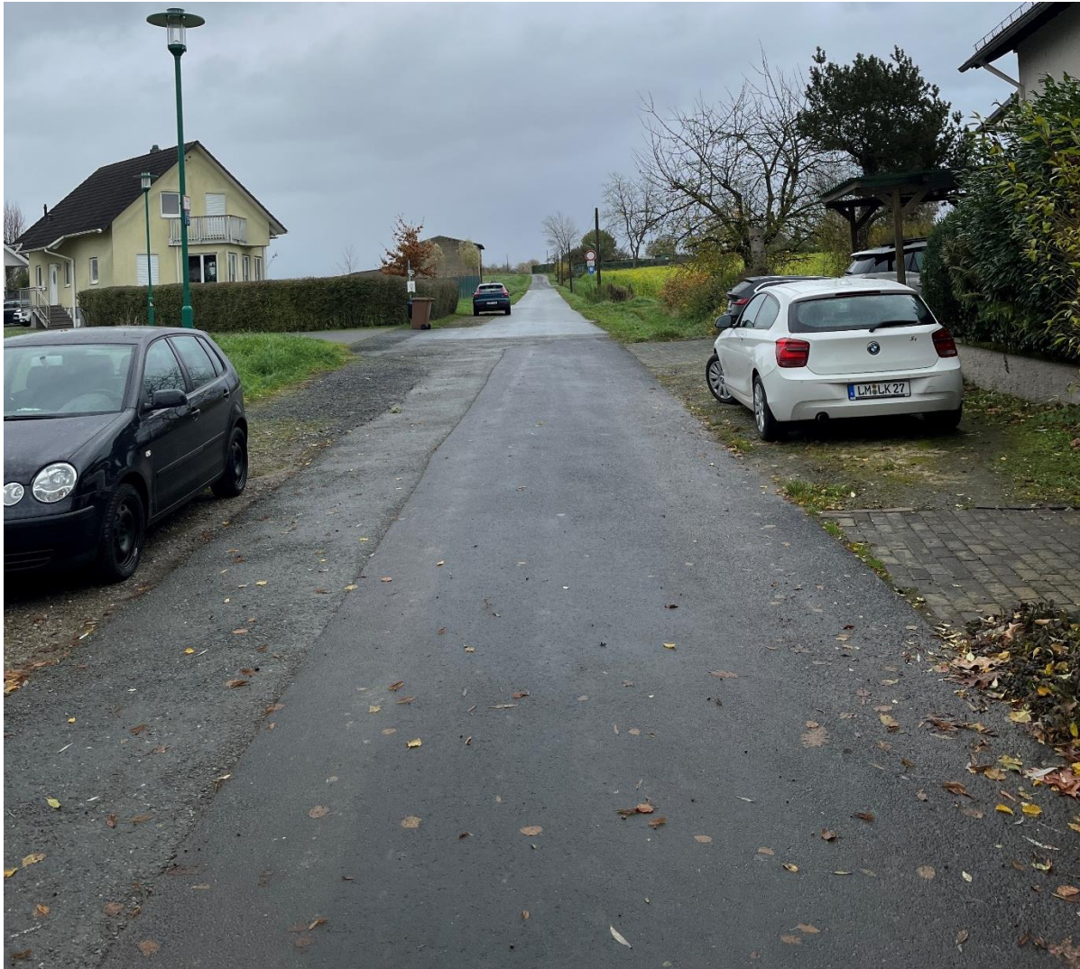
Abbildung 3: Kuhweg ohne Straßenentwässerung
