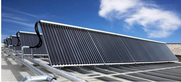
Vakuum Röhrenkollektorfeld Quelle: Ritter Solar XL
