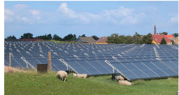
Flachkollektoren Quelle: Projekt Nahwärmeversorgung Marstal
