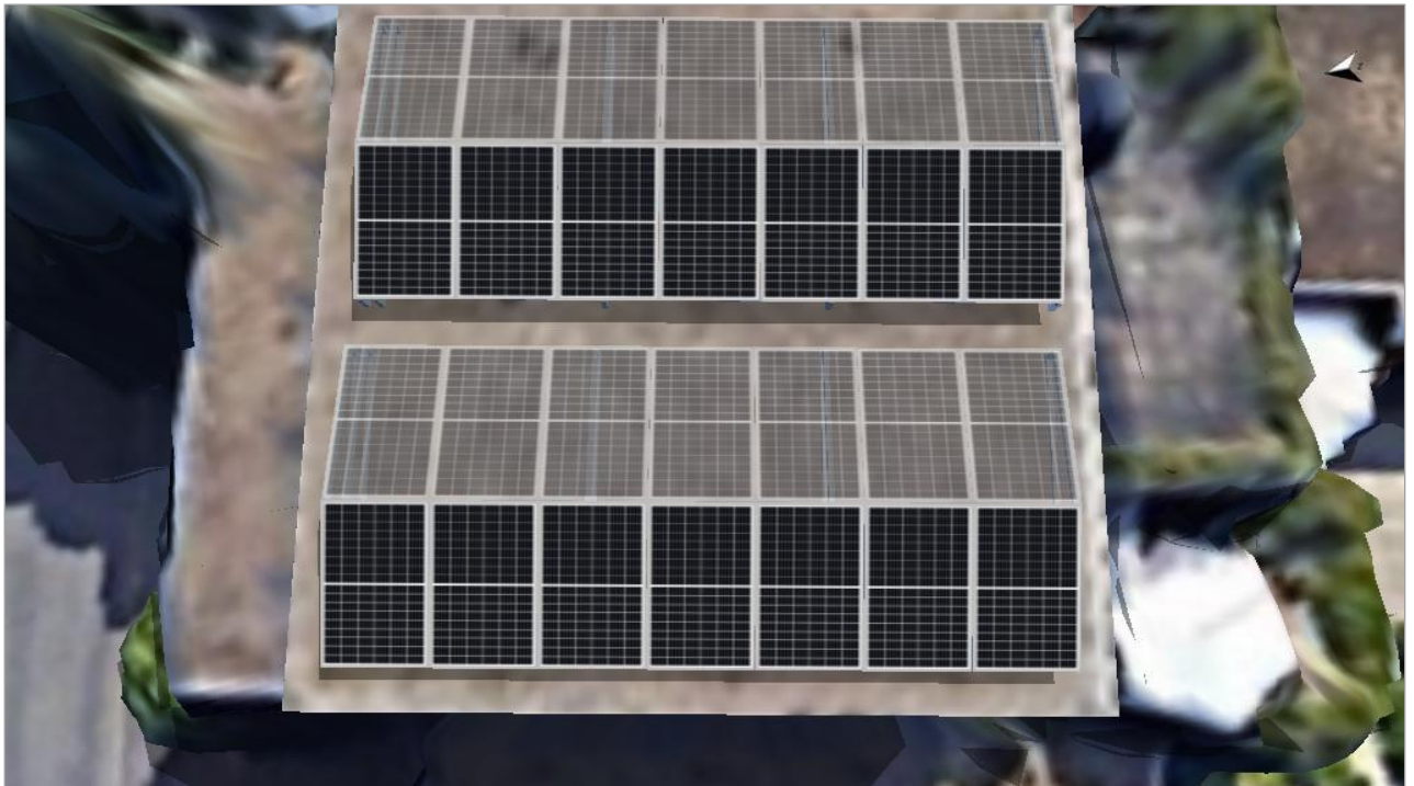
Abbildung: 2. Modulfläche - Gebäude 01-Modulfläche West
