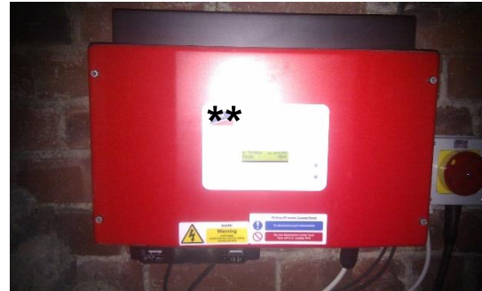
PV-Wechselrichter Quelle: SMA
