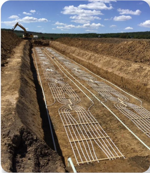
Kollektorfeld (704 Boden-Klima- Tauscher)
