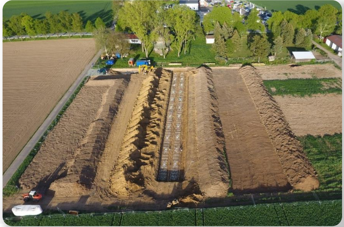
Kollektorfeld von oben (insg. 22.000 qm 2 )
